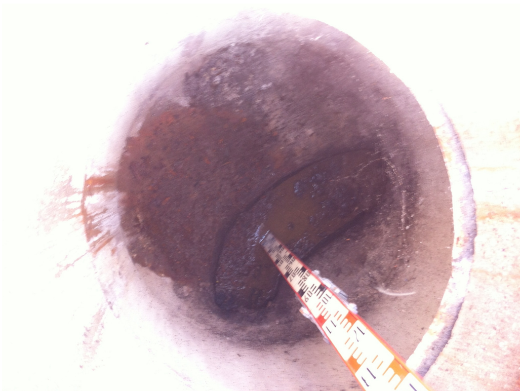
Figur 21: Måling af bundkote i brønd med kraftig slamaflejring i bundløbet.
